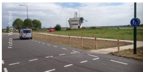
Foto: Wandelnet Er is een veilig wandelpad aangelegd langs de Lekdijk Oost in Wijk bij Duurstede
